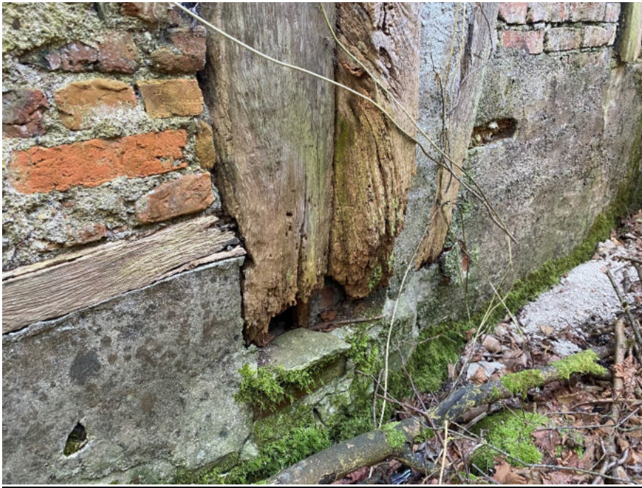
Bild 13: Hangseite, kernfauler Stützenfuß (Nordseite)
