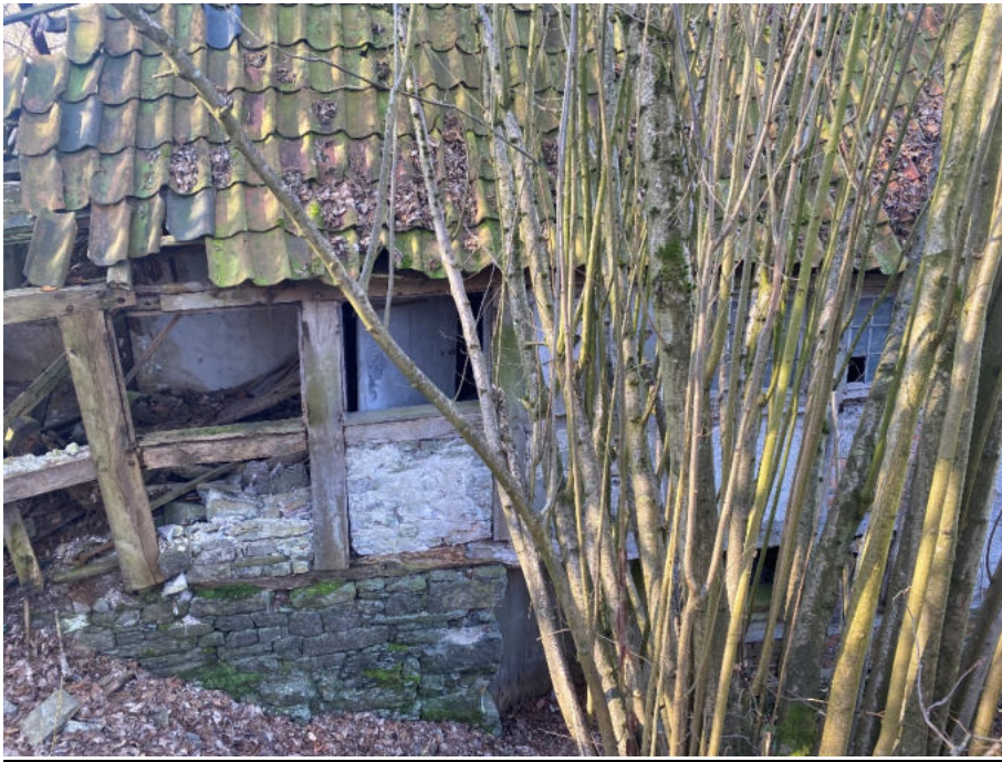
Bild 11: Hangseite, stark geschädigte und fehlende Gefache (Nordseite)
