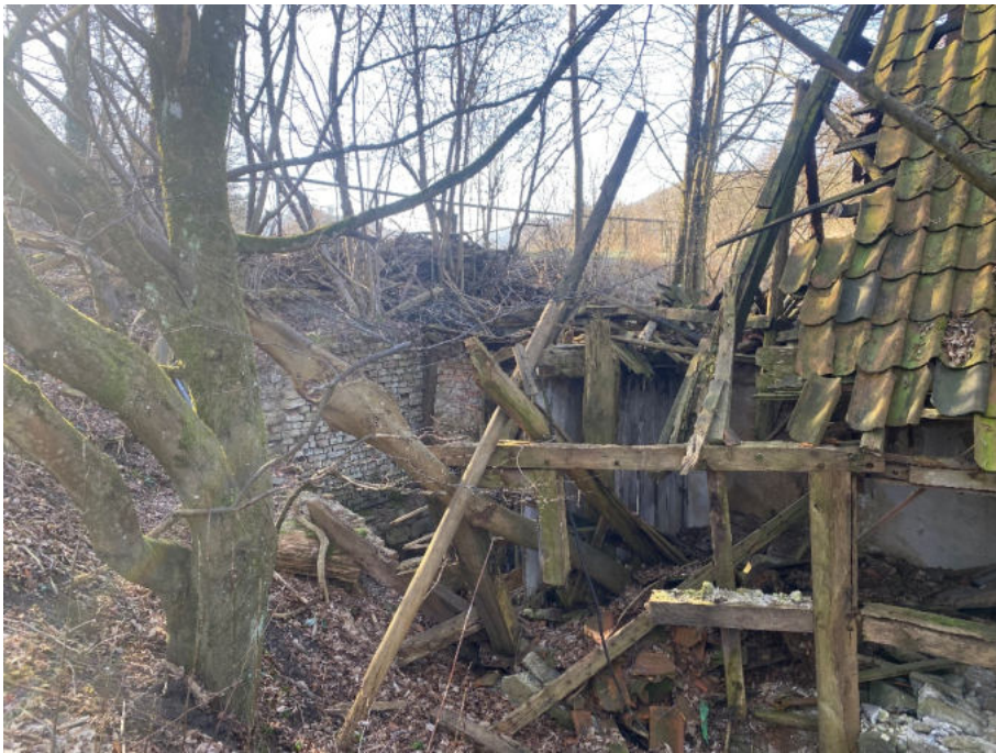
Bild 18: Hangseite, zerstörter linker Gebäudeteil mit geschädigter Ziegel-Stützwand zur Stauseite (Nordseite)
