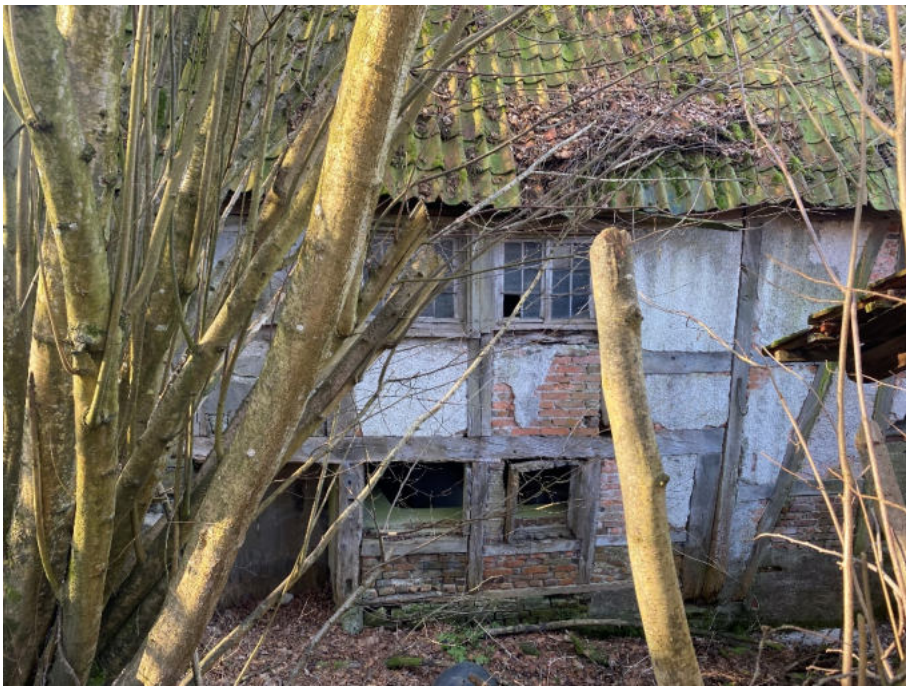
Bild 12: Hangseite, abgängige Dacheindeckung inkl. Lattung und Tragkonstruktion (Nordseite)
