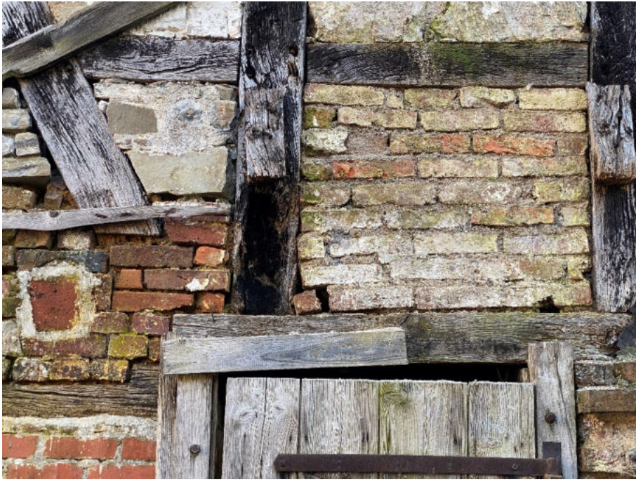
Bild 3: Wasserseite, schadhaftes Ziegelmauerwerk (Südseite)
