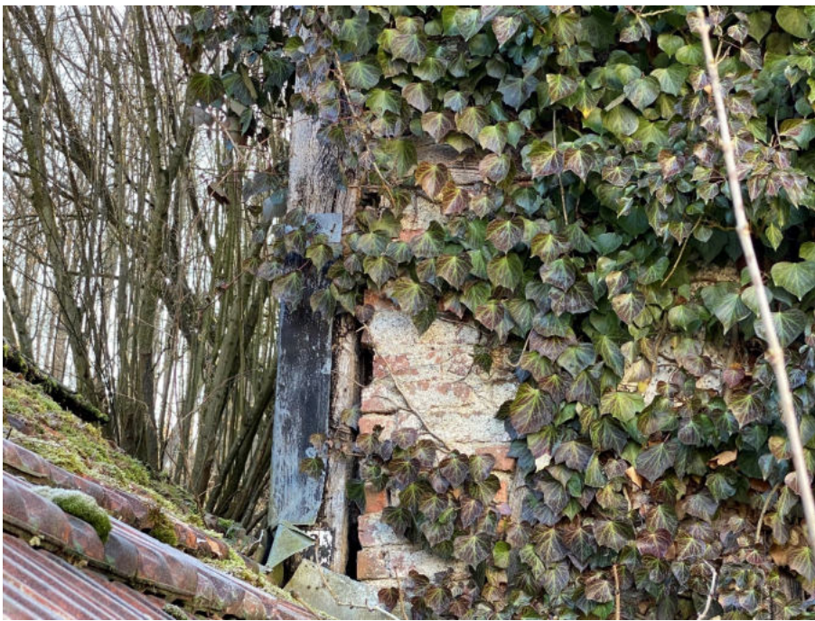
Bild 10: Hofseite, kernfaule Eckstütze, schadhaftes Mauerwerk (Westseite)
