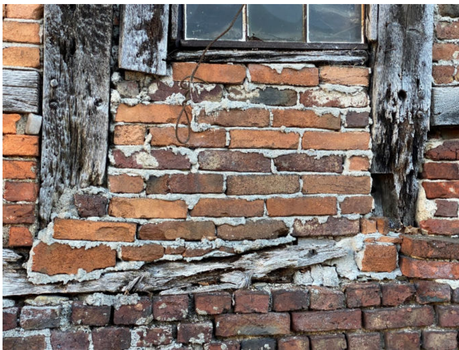
Bild 2: Wasserseite, stark geschädigte Fachwerkkonstruktion, notdürftig ausgebesserte Gefache (Südseite)
