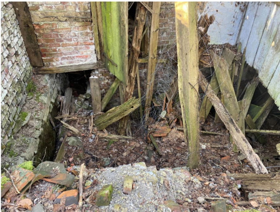
Bild 20: Stauseite, zerstörter Gebäudeteil (Ostseite)
