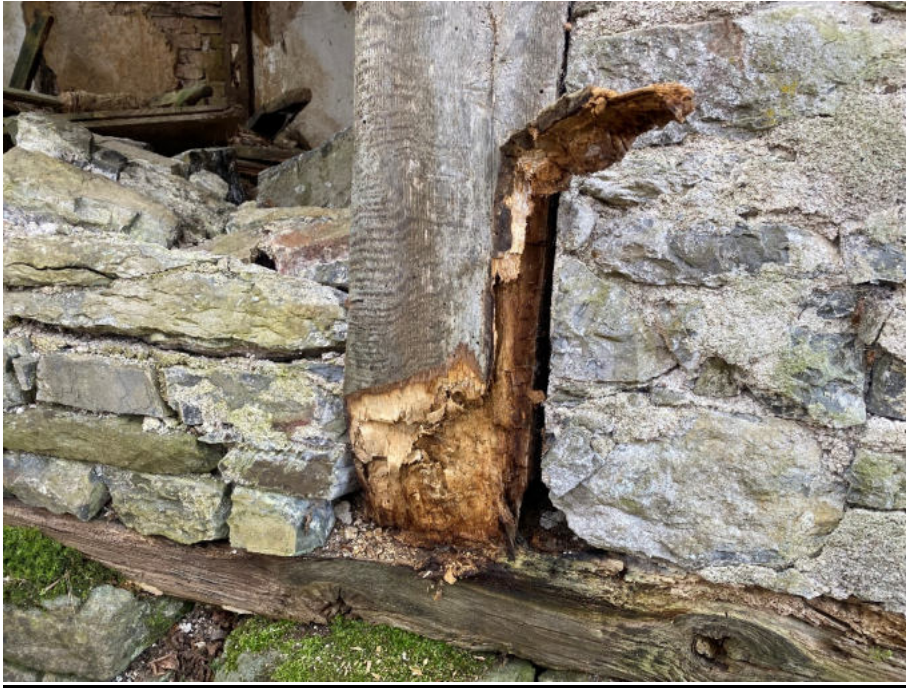
Bild 17: Hangseite, kernfauler Stützenfuß (Nordseite)
