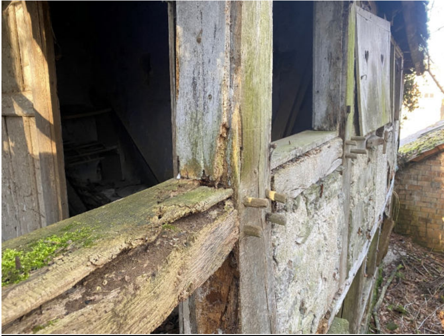
Bild 15: Hangseite, kernfauler Riegel (Nordseite)
