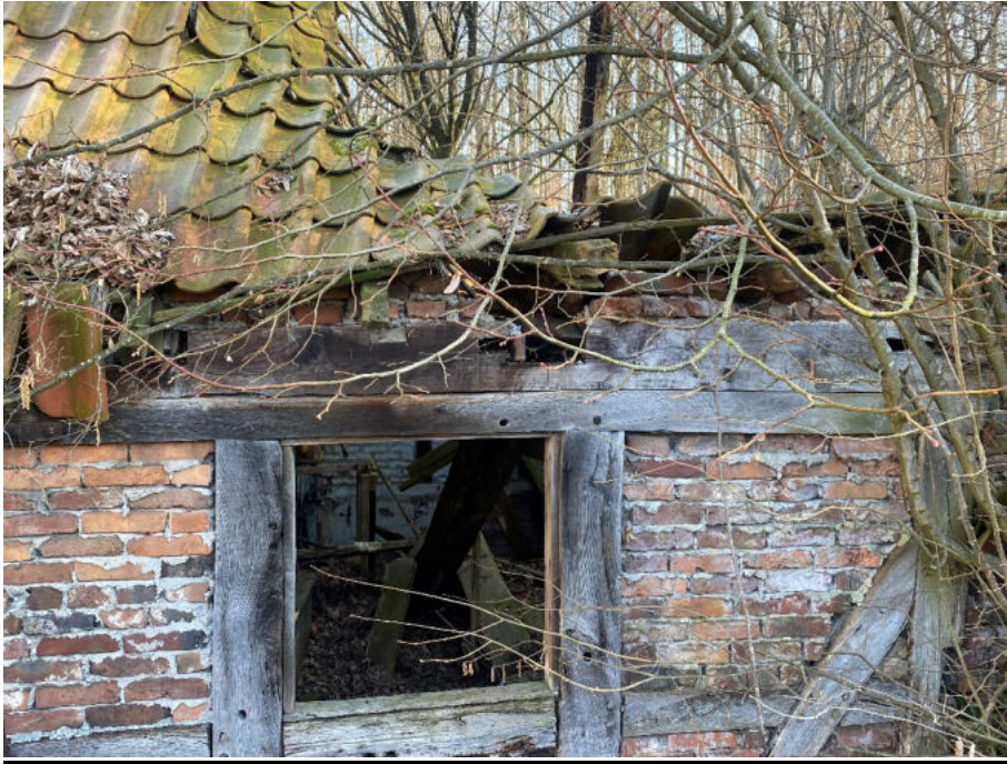
Bild 7: Wasserseite, zerstörte Dachfläche, kernfaules Rahmholz (Südseite)
