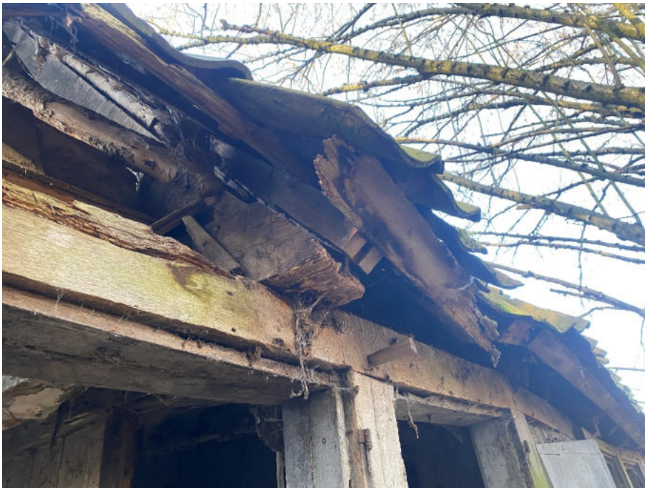
Bild 16: Hangseite, zerstörter Traufbereich (Nordseite)
