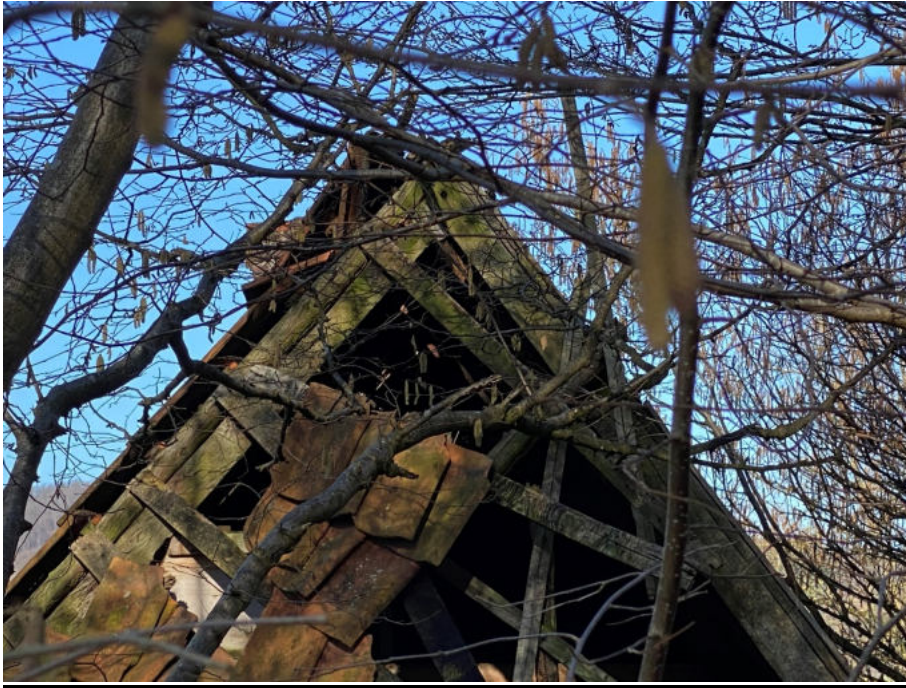
Bild 21: Stauseite, zerstörter Gebäudeteil (Ostseite)
