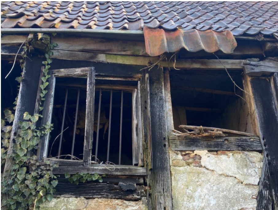
Bild 4: Wasserseite, abgängiger Traufbereich, zerstörtes Fenster (Südseite)
