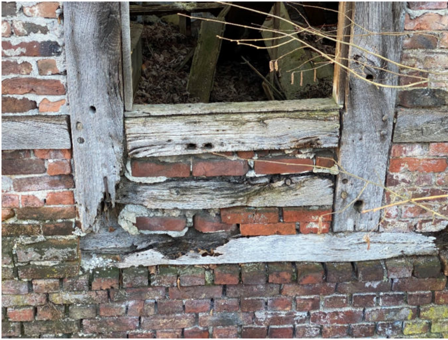
Bild 6: Wasserseite, kernfaule Fachwerkkonstruktion im Öffnungsbereich (Südseite)
