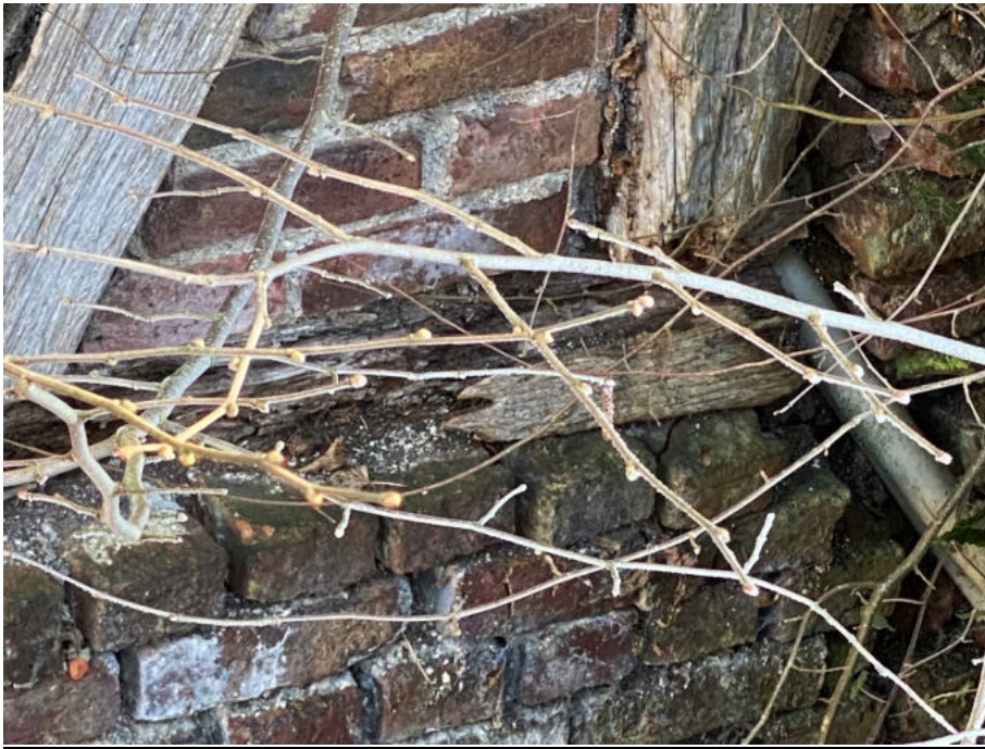
Bild 5: Wasserseite, kernfaules Schwellholz und kernfaule Stütze (Südseite)
