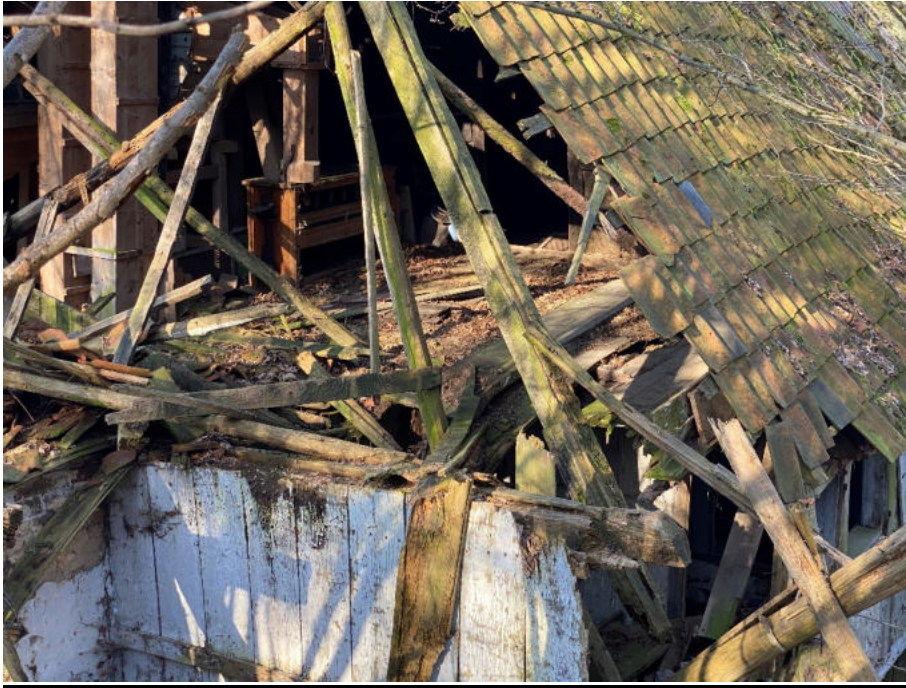
Bild 19: Stauseite, zerstörter Gebäudeteil (Ostseite)
