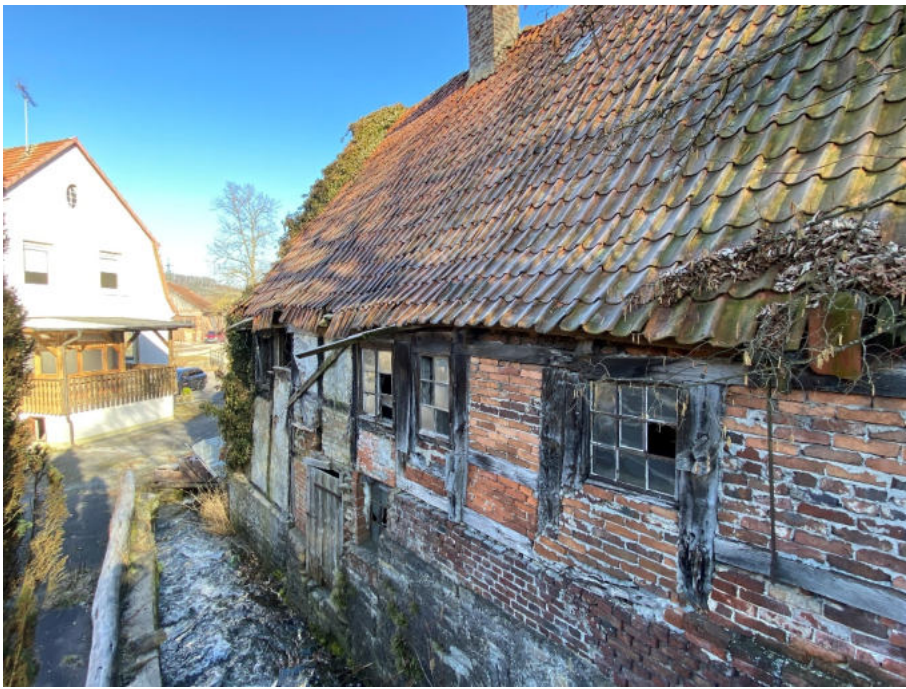
Bild 8: Wasserseite, schadhaftes Mauerwerk, abgängige Traufe, schadhafte Dacheindeckung (Südseite)
