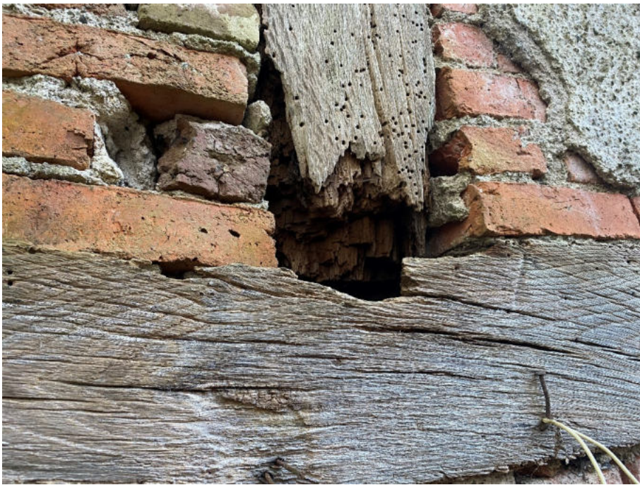
Bild 14: Hangseite, kernfaule Stütze auf kernfaulem Riegelholz (Nordseite)
